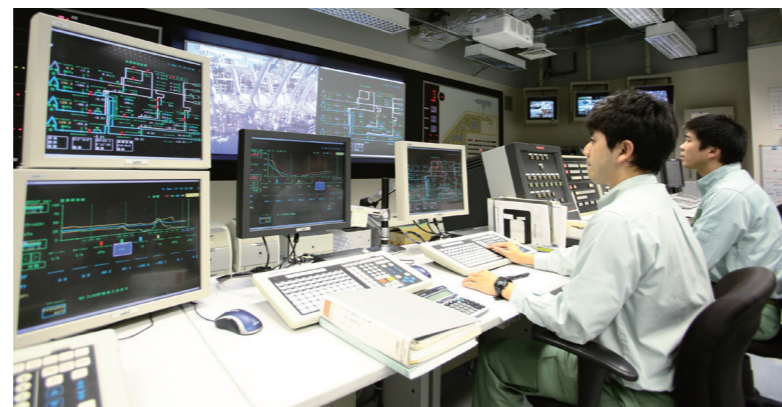
清水エル・エヌ・ジー袖師基地中央制御室
